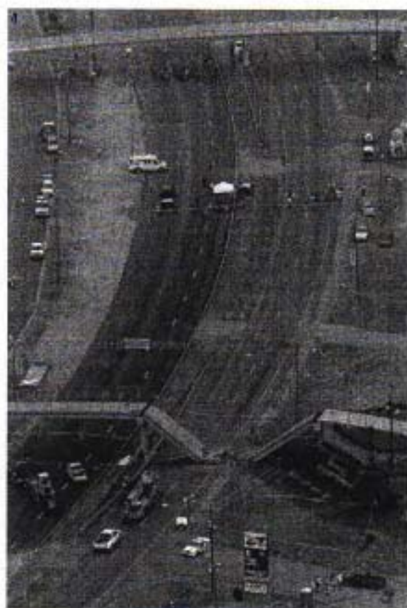
4. Uno dei due ponti pedonali sulla Lowe's Motor Speedway crollati nel maggio 2000.
