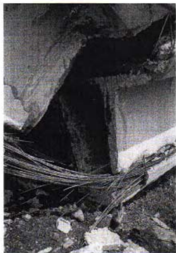
2, 3. La struttura del ponte S. Stefano dopo il collasso. Distacco dei conci di prefabbricazione ed estrazione dei cavi di precompressione.
