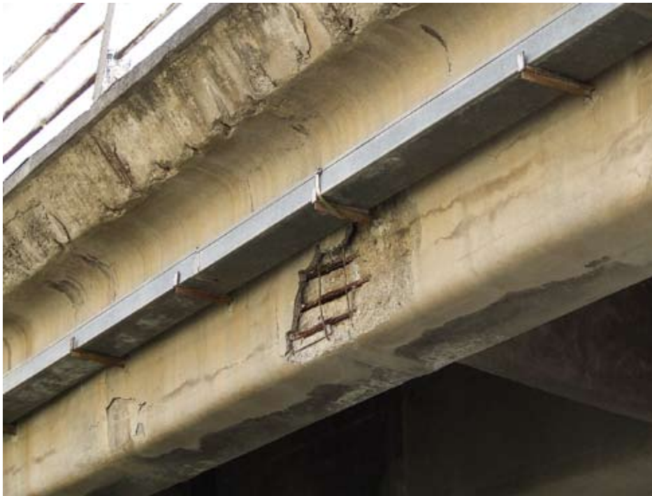
Figura 9 - Spalling ed esposizione delle armature dei cavi. Sull'intradosso della trave sono evidenti macchie di umidità
