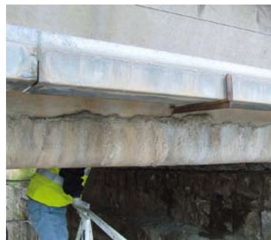
Figura 7 - Particolare delle fessure rilevate
