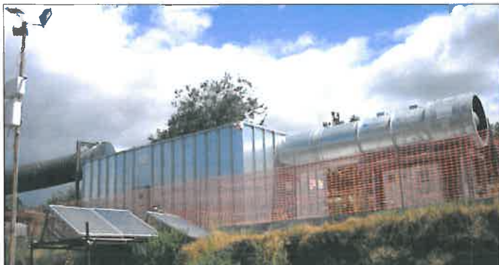
Figura 7 - L'impianto di abbattimento polveri installato nel Maggio 2009 al Cantiere 1, costituito dall'accoppiamento in serie di una torre di lavaggio e di un filtro assoluto
