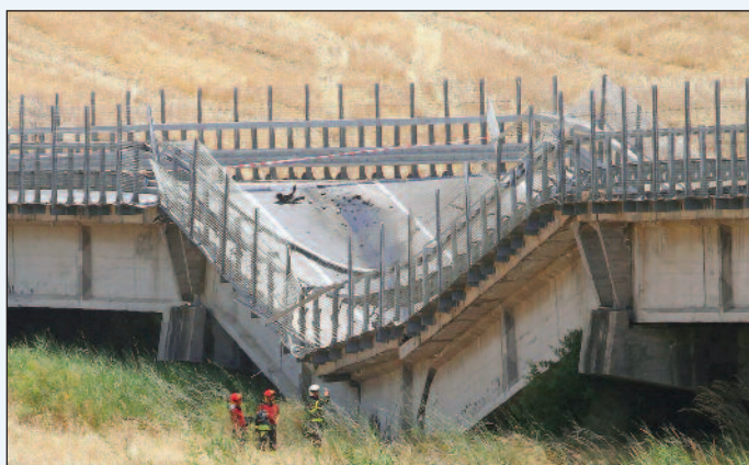
1. Un particolare del crollo del viadotto Petrulla sulla S.S. 626 Licata-Ravanusa (AG)
