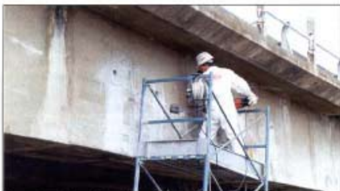
Scoperta dei cavi lungo la lesione longitudinale
