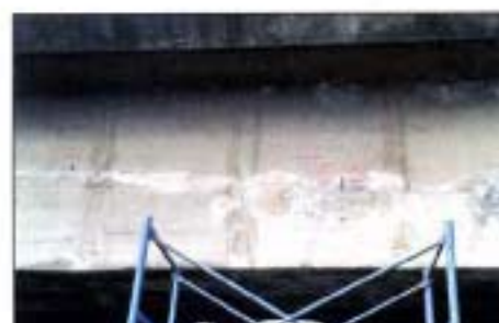
Lesione longitudinale con efflorescenze sulla trave 5
